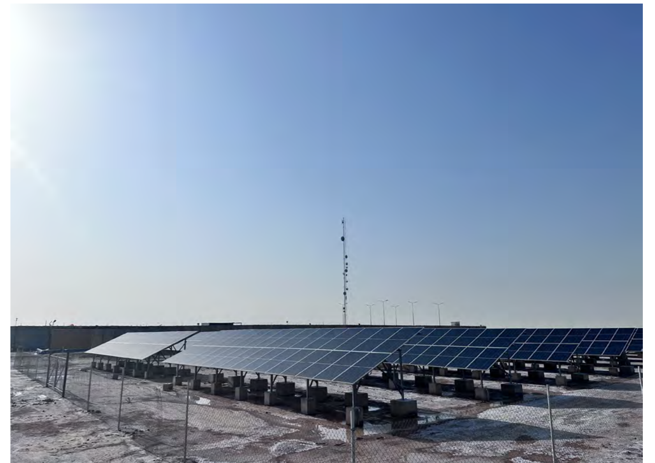
KEBL 營地油田光伏電站項目
